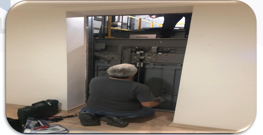
A Blok sol asansörünün arızalı fotoseli yenisi ile değiştirilmiştir.
