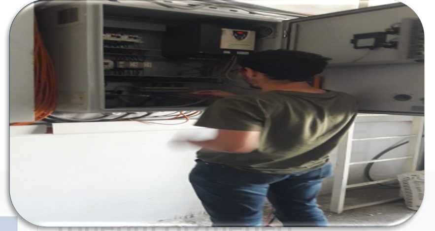
Otomasyon sistemi periyodik kontrolleri gerçekleştirilmiştir.
