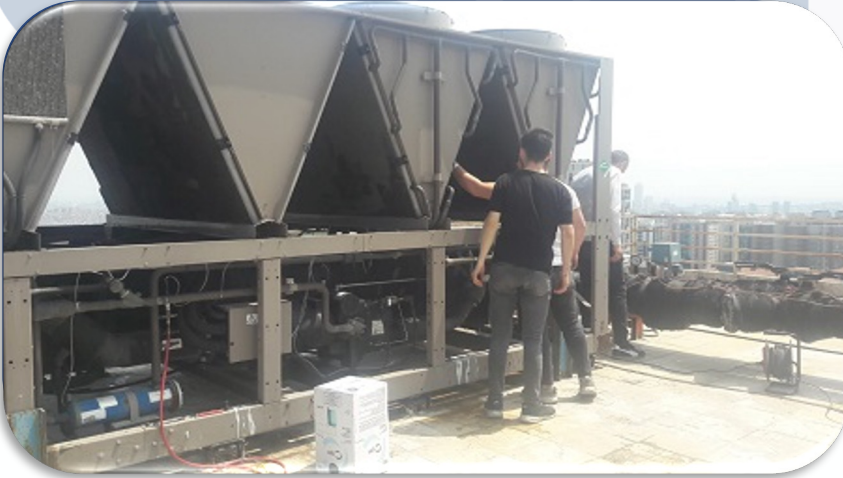
Chiller Soęutma Sistemi periyodik kontrolleri gerekleřtirilmiřtir.
