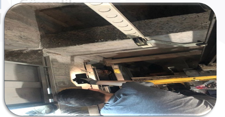
Asansörlerin aylık bakım faaliyeti gerçekleştirilmiştir.
