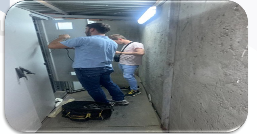
CK Elektrik yetkili personelleri tarafınca A Blok ortak alan modem deęiřiklięi gerekleřtirilmiřtir.
