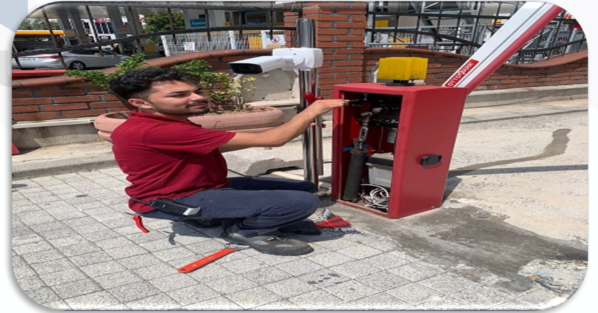
Kapalı otopark giriş bariyerinin periyodik kontrolleri gerçekleştirilmiştir.
