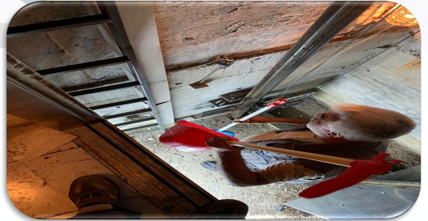
Asansörlerin aylık bakım faaliyeti gerçekleştirilmiştir.
