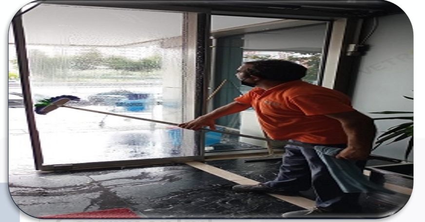
Bina giriş kapıları yıkanmıştır.
