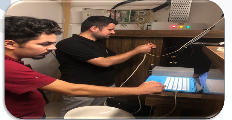
Endesk değeri okunamayan bb süzme sayaçlarının kontrolleri gerçekleştirilmiştir.
