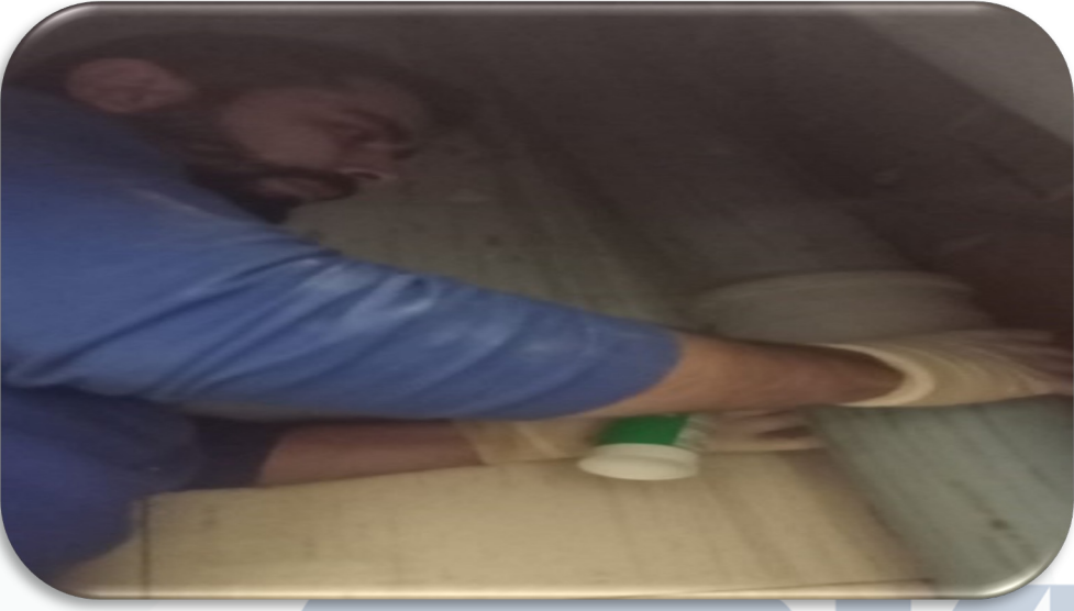
3.Kat ortak alan pimaş çatlağına teknik müdahalede bulunulmuştur.
