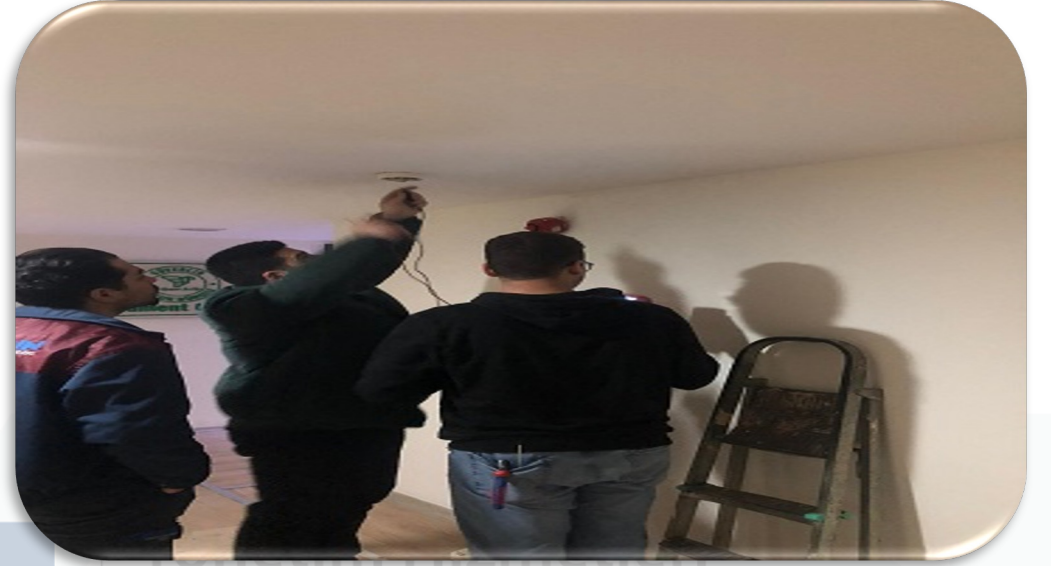
Yangın algılama periyodik sistem kontrolleri gerçekleştirilmiştir.
