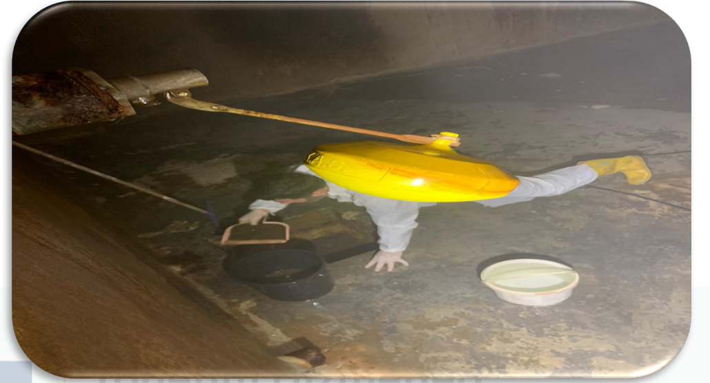
Kullanım suyu deposunun periyodik temizliği gerçekleştirilmiştir.
