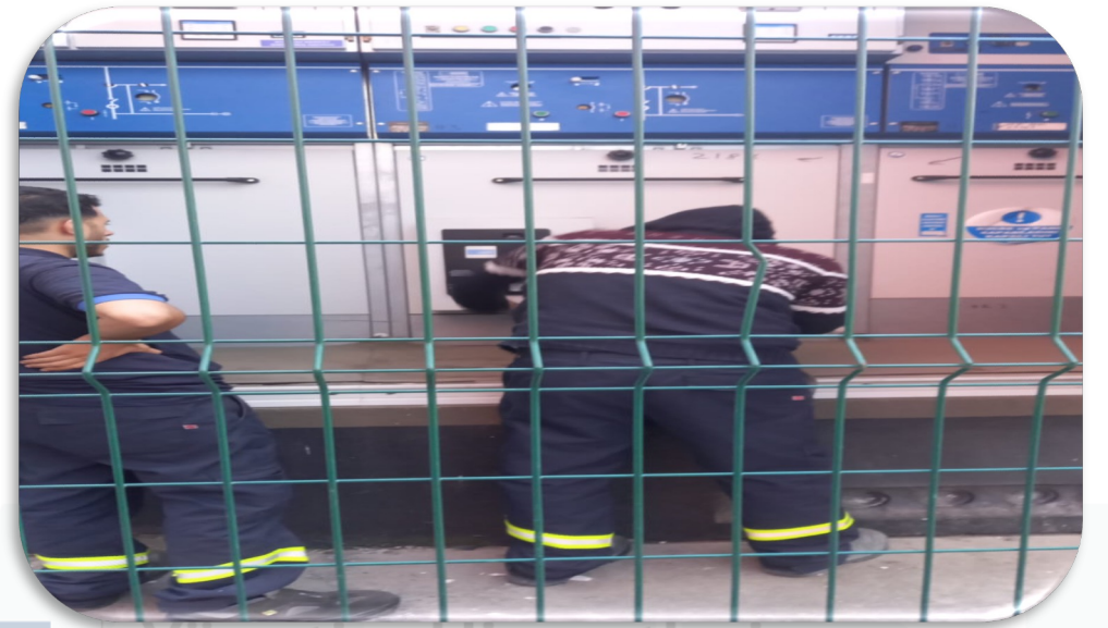
Elektrik ana dağıtım pano kontrolleri gerçekleştirilmiştir.
