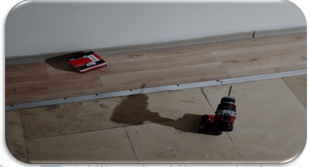
Ortak alan eşik çitalarının hasar kontrolleri gerçekleştirilmiştir.
