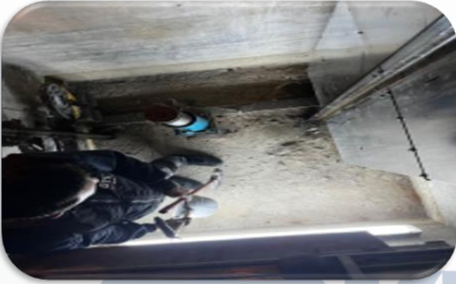
Asansörlerin aylık bakım faaliyeti gerçekleştirilmiştir.
