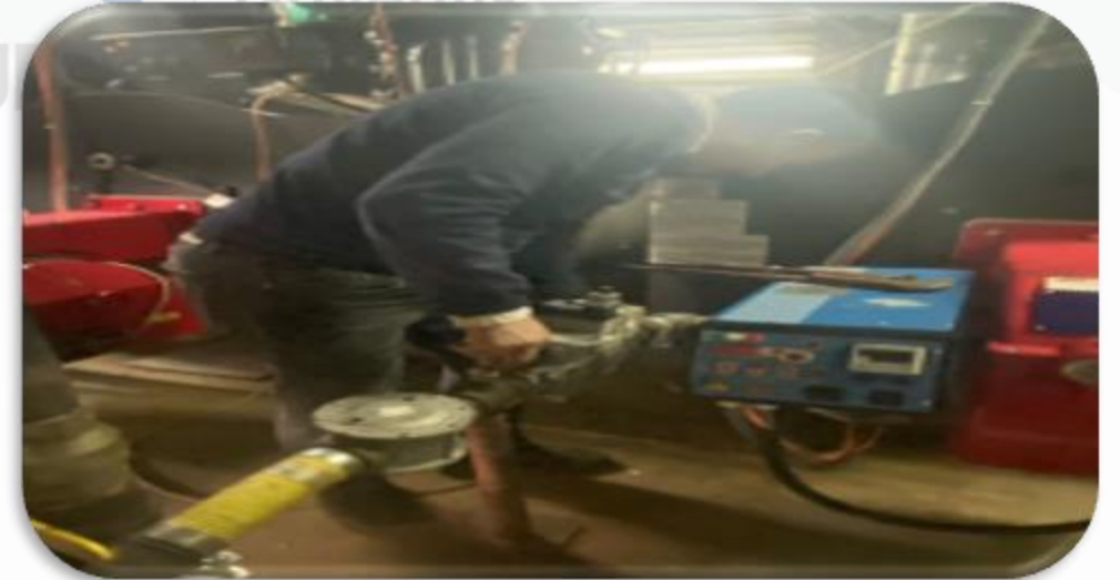
Isıtma sistemi kontrolleri sağlanmıştır.
