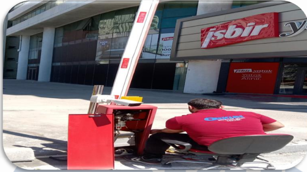
Bariyer kolunun arızalı fotoseli yenisi ile değiştirilmiştir.
