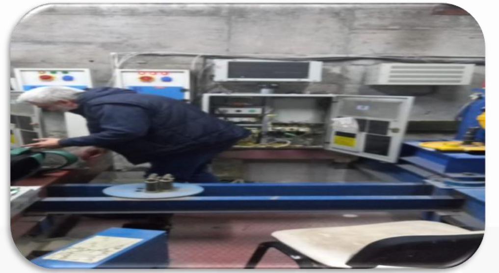
A Blok sağ asansör sürücü arızası giderilmiştir.
