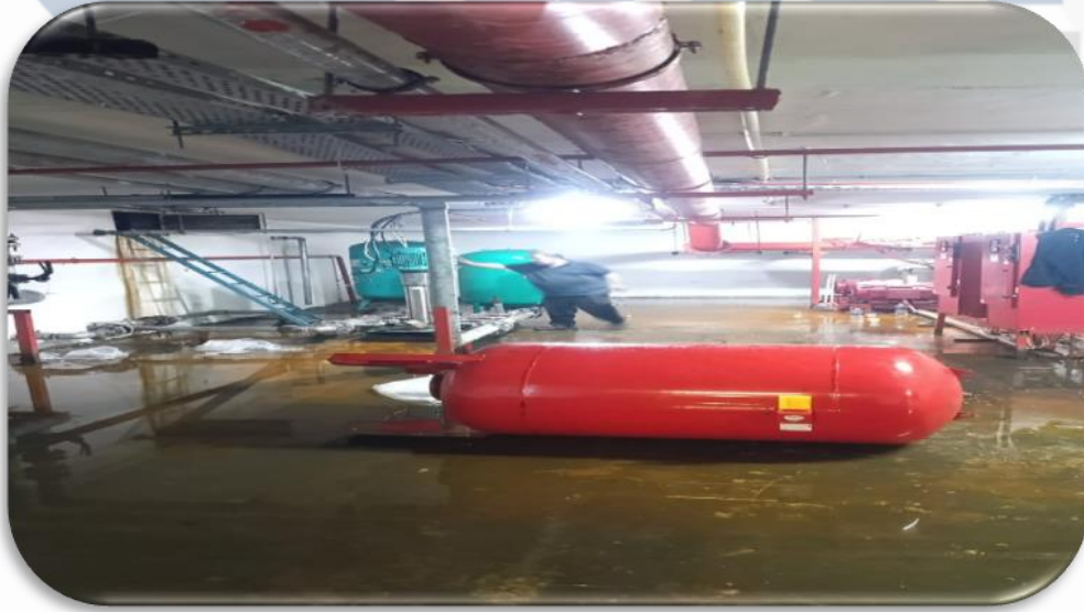
Hidrofor sistemi arızalı genişleme tankı yenisi ile değiştirilmiştir.
