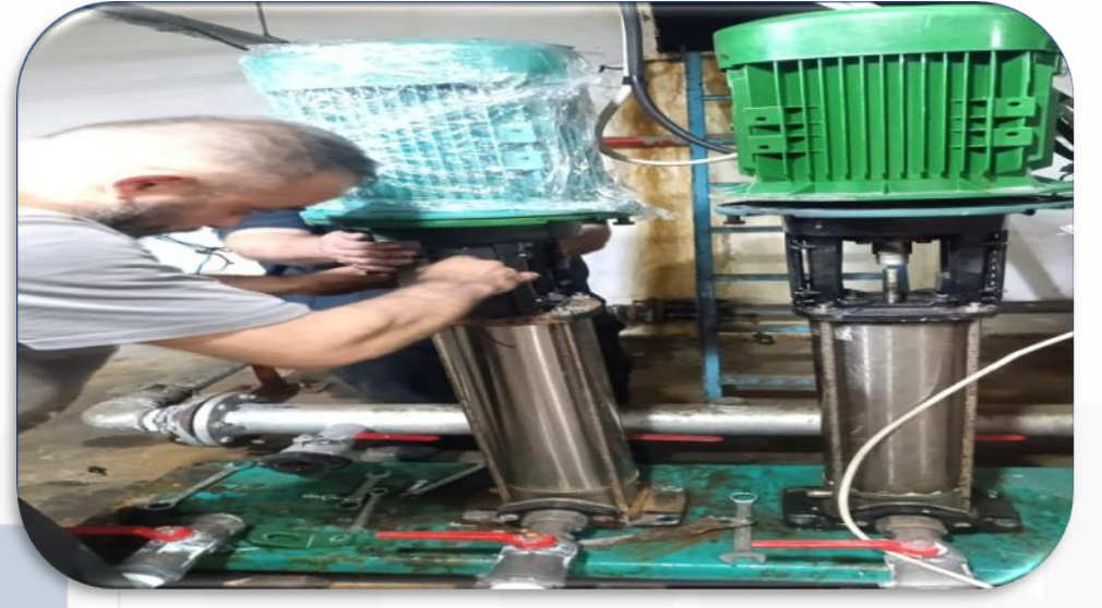
Hidrofor sistemi pompa arızası giderilmiştir.
