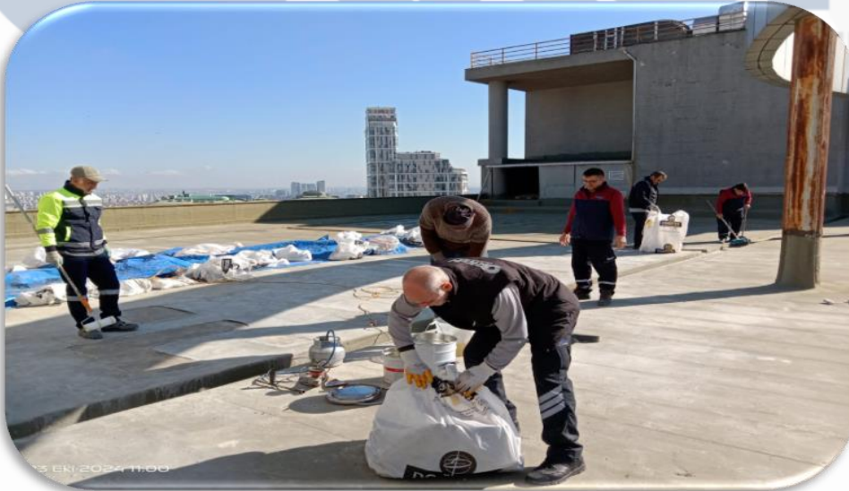
Isıtma sistemi teras katındaki su dönüş hattı su kaçağı giderilmiş ve tadilat/izolasyon çalışmaları tamamlanmıştır.
