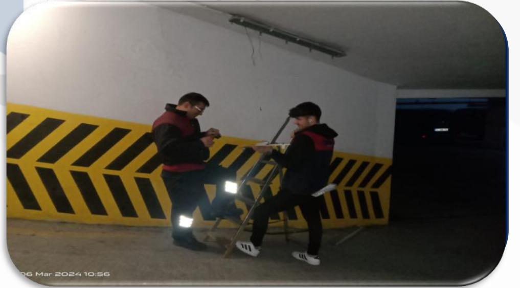
Bina geneli arızalı aydınlatma kontrolleri gerçekleştirilmiştir.
