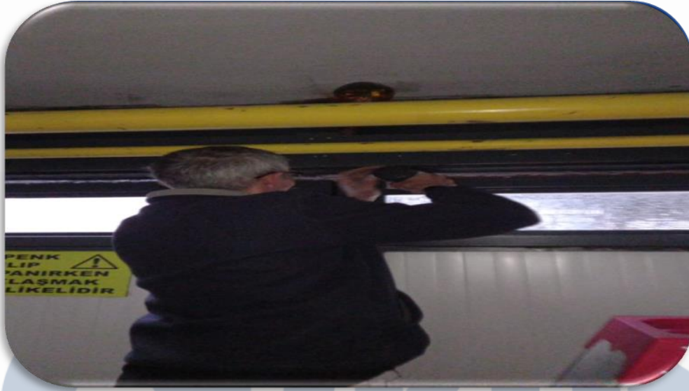
Otopark çıkış kepenginin sol kanat arızası dolayısıyla ile gerekli kontroller sağlanmıştır.
