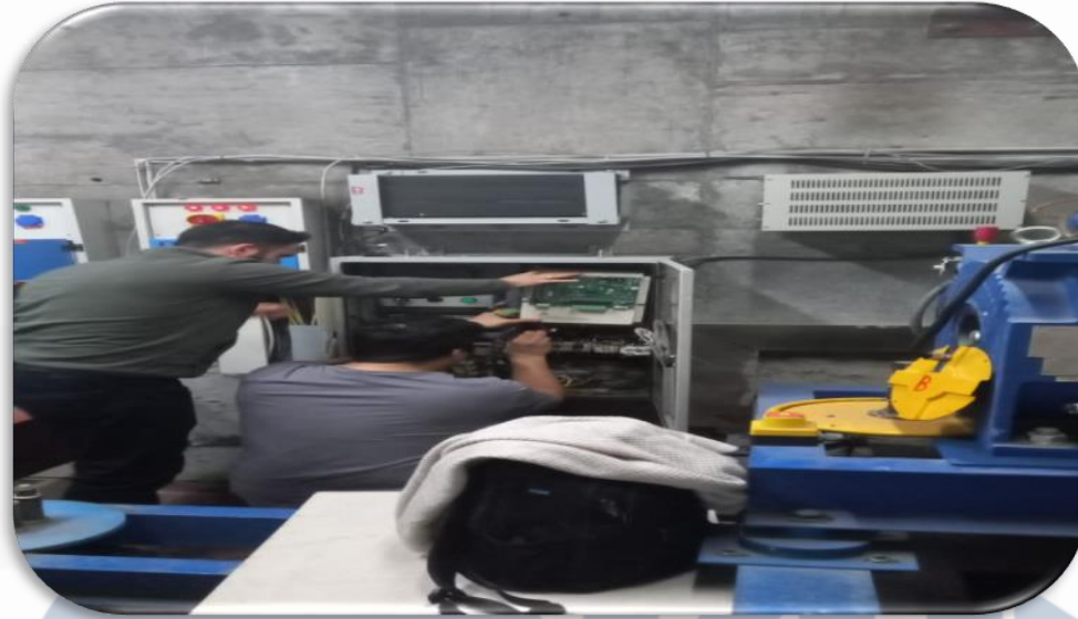
A Blok sol asansörü inverter arızasına ilişkin çalışmalar yürütülmüş, arızalı inverter yenisi ile değiştirilmiştir
