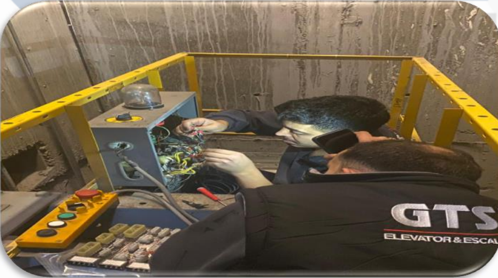
Asansörlerin aylık bakım faaliyeti gerçekleştirilmiştir.
