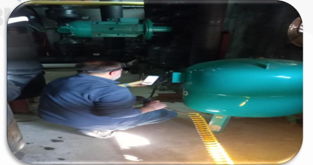
Isıtma Sistemi genleşme tanklarının hava kontrolleri sağlanmıştır.
