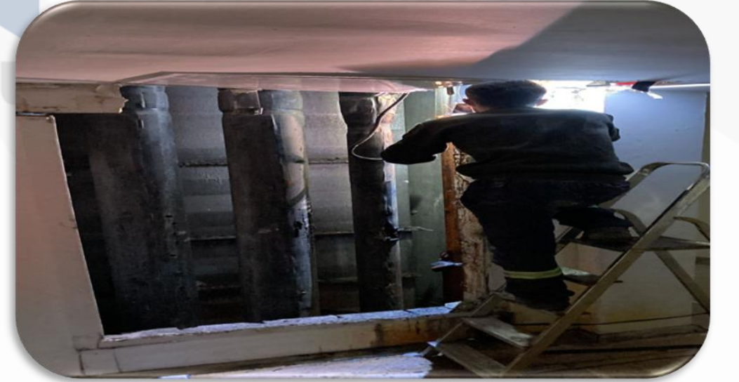
11,4 ve 3.katlardaki ısıtma sistemi sıcak su dönüş hattı kaçaklarına müdahalede bulunulmuştur.
