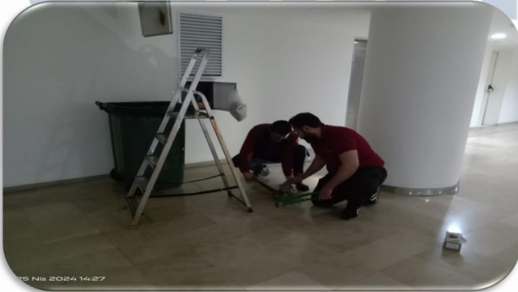
2.Kat ortak alan su hattındaki arızalı basınç düşürücü yenisi ile değiştirilmiştir.
