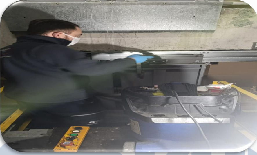
Asansörlerin aylık bakım faaliyeti gerçekleştirilmiştir.
