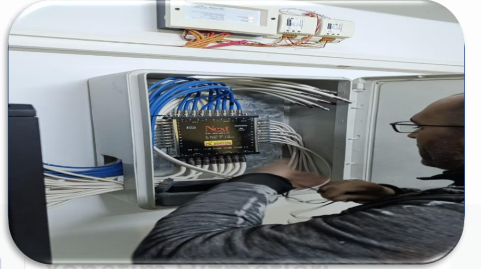
Uydu sistemi periyodik kontrolleri gerçekleştirilmiştir.
